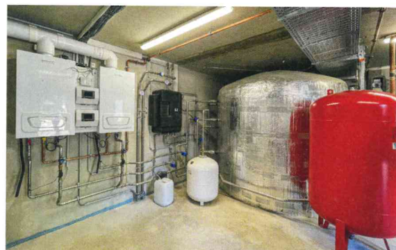
Um den möglichen Solarertrag bestmöglich nutzen zu können, wurden große Pufferspeicher installiert
